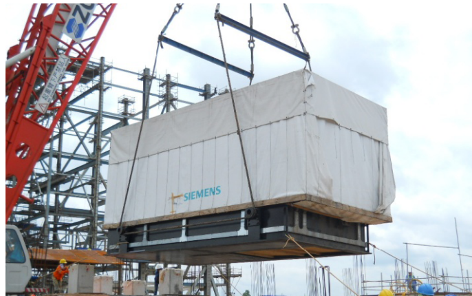
MSW, anak perusahaan AE, menerima dan memasang turbin uap Siemens pada bulan Pebruari 2011
